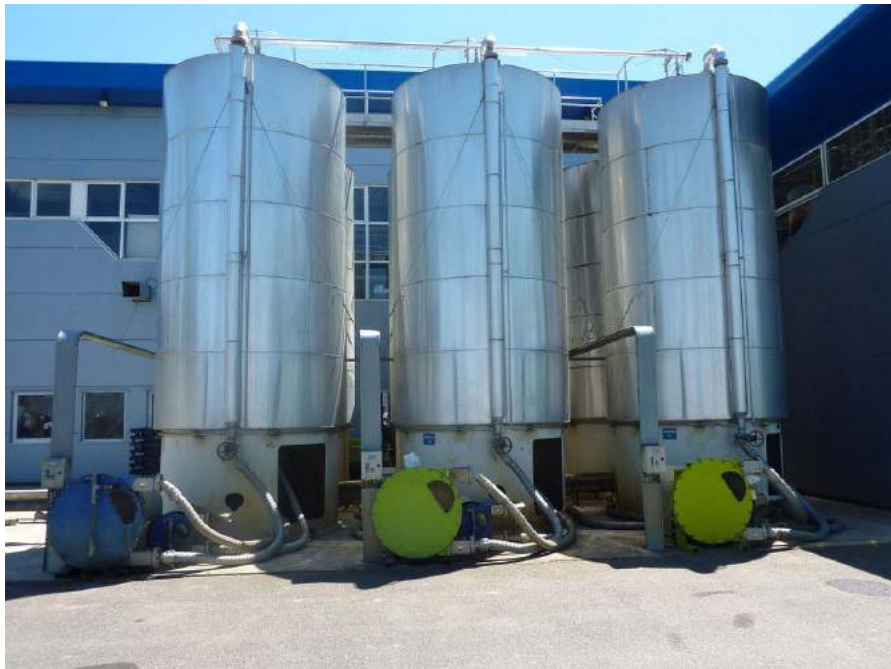
Les 6 cuves de 30 tonnes
